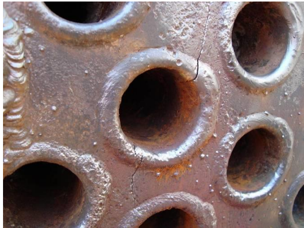
Pukotina na mostiću i zavaru
