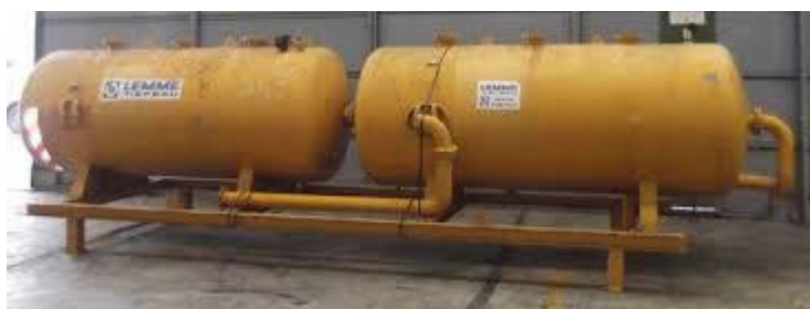
Horizontalni spremnici stlačenog zraka
